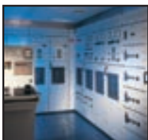
LSP-Ställverk i fast utförande
